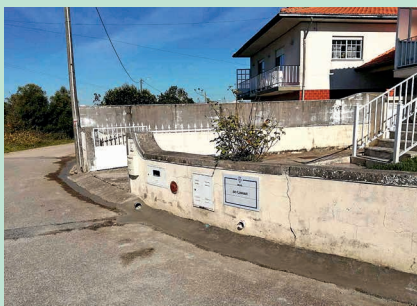
Valetas na Rua do Linhar Póvoa do Valado
