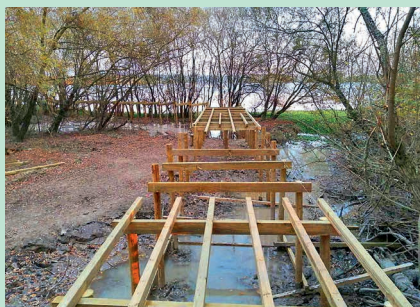
Acompanhamento da obra da via pedonal /ciclável entre os Parques Ribeirinhos de Requeixo e Carregal
