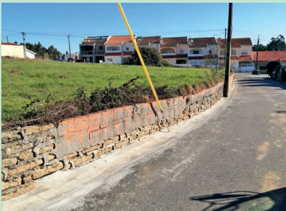
Valetas na Rua do Chão de Baixo e Rua Nova – Carregal
